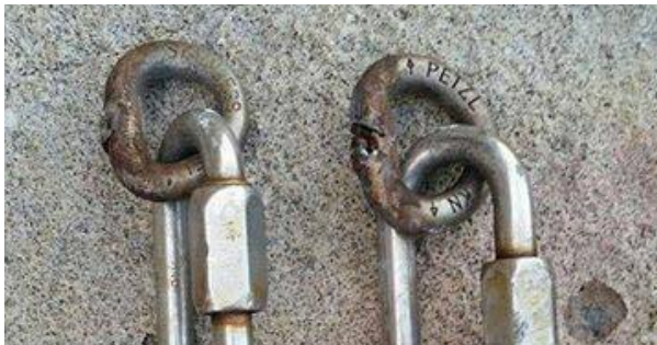
音樂廳 - 大鼓路線的上方固定點 岩友於 2015 年七月份利用其撤退時 發生斷裂意外 (兩支錨栓同時斷裂) 所幸當事人僅受輕傷並無大礙
